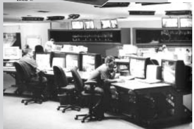
Centro Integrado de Control.
